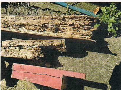
→腐食した材木
